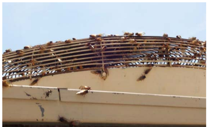
Cicadas Swarming RTU Exhaust Fan
